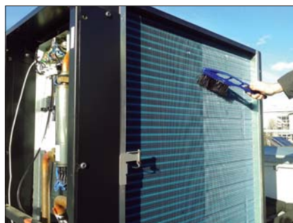
Obr. 6 Čištění vzduchového výměníku tepelného čerpadla
