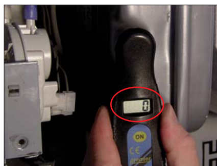
Obr. 3 Kontrola tlaku expanzní nádoby (nevyhovující hodnota tlaku)
